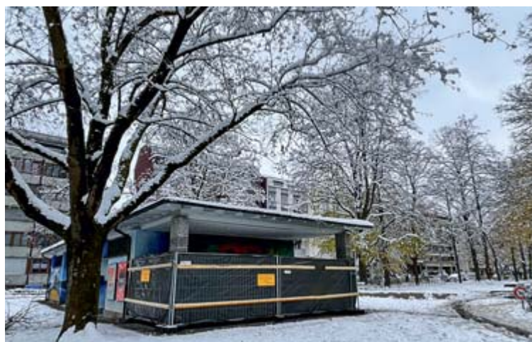
Die Trafostation am Winkelriedplatz wurde vor kurzem «eingepackt».
